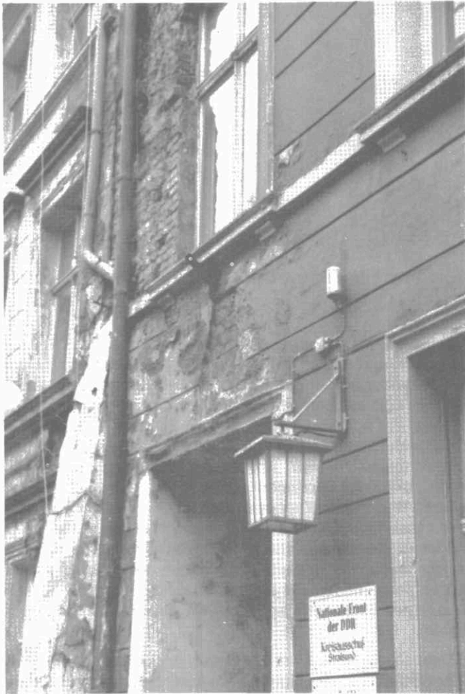
Fassade ohne Putz – ein übliches Bild in der DDR... „Nationale Front“
