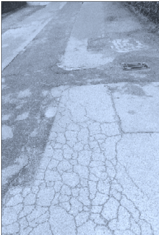
Der Zustand des Hufenkamps. Erneuerung nicht erforderlich?
